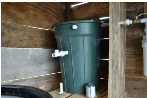
Figura 3. Filtro de remoción de arsénico.
